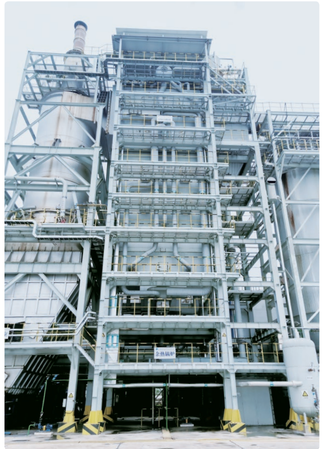
餘熱鍋爐產熱
